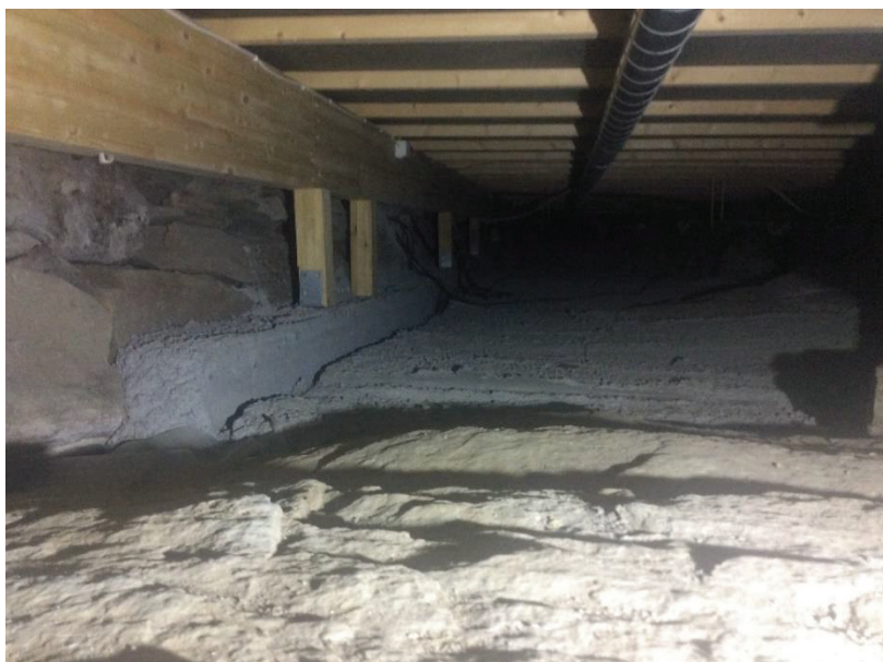
Foto: John Morten Espevik. Bilde viser bjelke og fundament under kyrkjegolvet.
